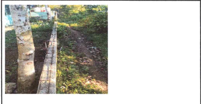
muestra el muro perimetral inconcluso
