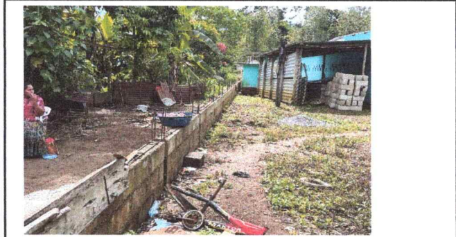
muestra el muro perimetral inconcluso
